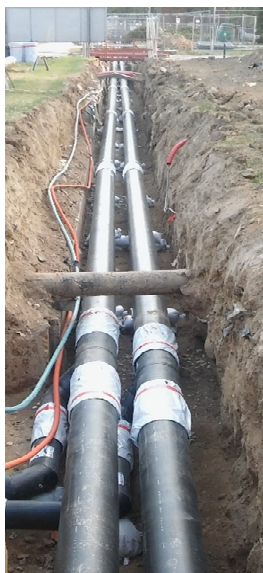
Horkovod v ulici Pražská
